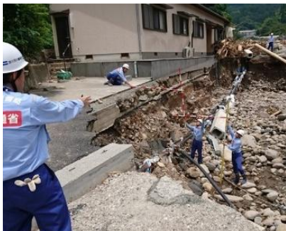
河川被害状況の調査
