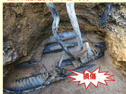
図面と既設埋設管の位置が異なっていた！
