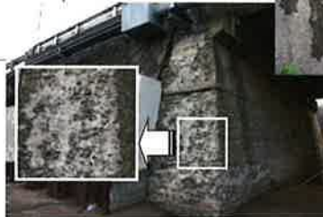
コールドジョイント からの劣化進行例 出典)寒地土木研究所
