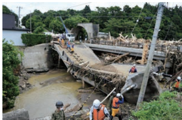
災害による落橋現場
