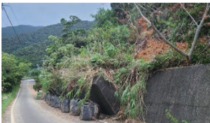
図2 道路側に倒壊した擁壁
